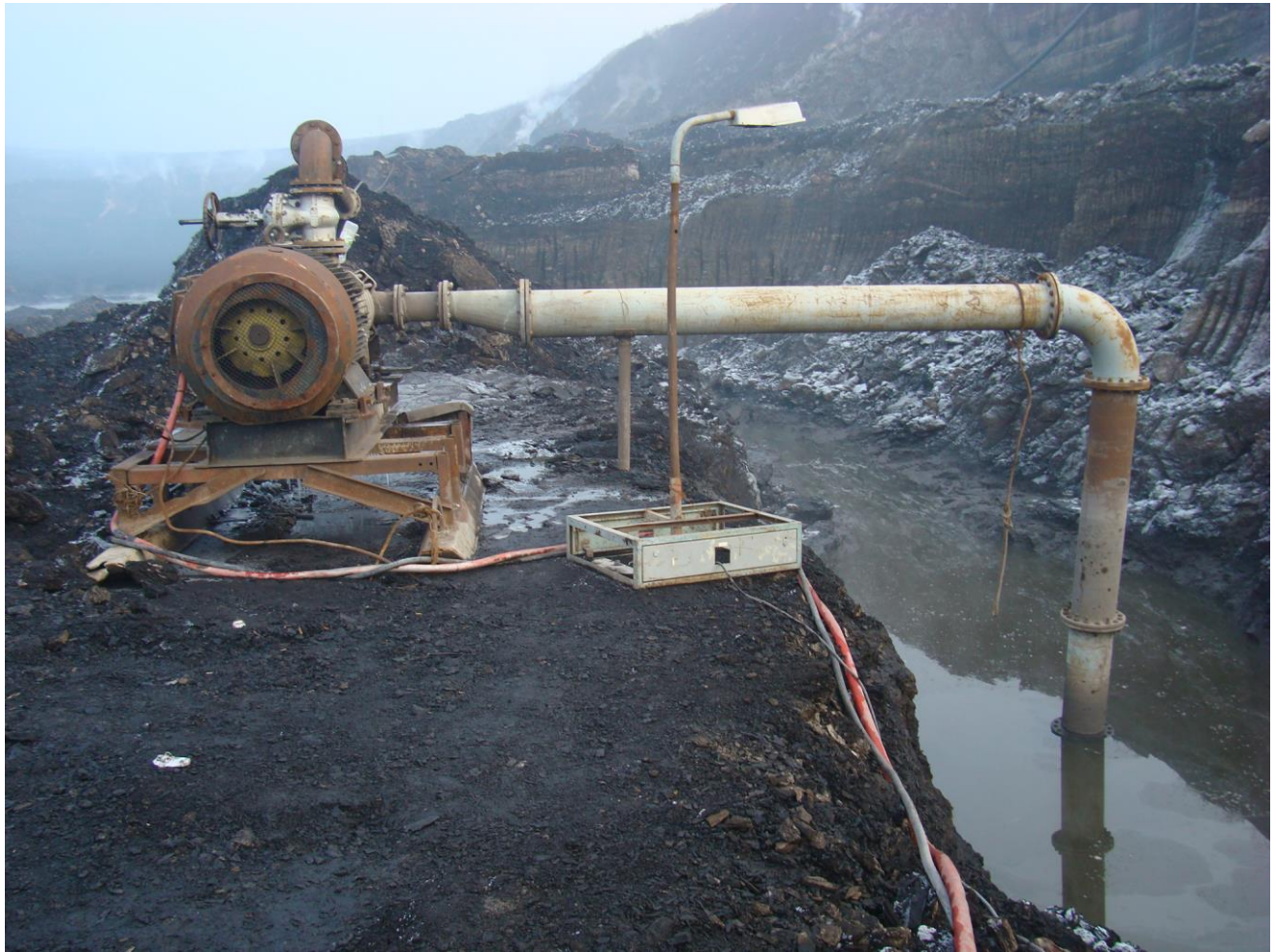
Foto-4 Stacion i pompimit në pikën më të ulët në shkallën qymyrore të Sibovcit JP (Ternava B, nëntor 2020)
